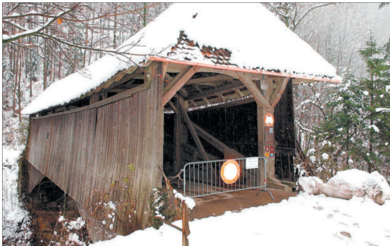
Die Suworow-Brücke im Schlattli ist ab sofort gesperrt.
