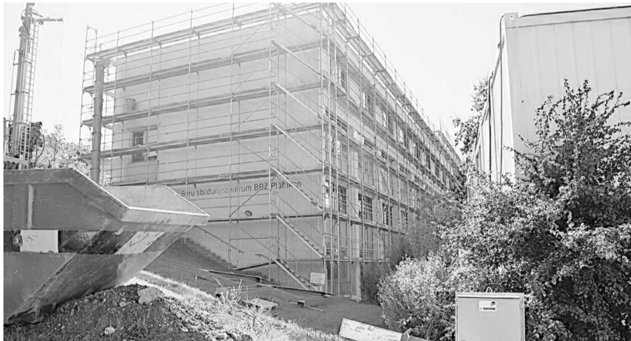
Es hat ziemlich geillt: Die Ausschreibung der Arbeitsvergaben für die Sanierung des Berufsbildungszentrums Pfäffikon fielen zum Teil in die Sommerferien. «Ein Fehler», räumt Baudirektor Lorenz Bösch ein. Bild Archiv
